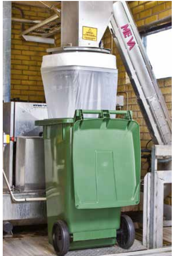
La Planta municipal de tratamiento de las aguas residuales de Staffanstorp en Suecia ha instalado un Longopac Fill para el tratamiento del cribado.
